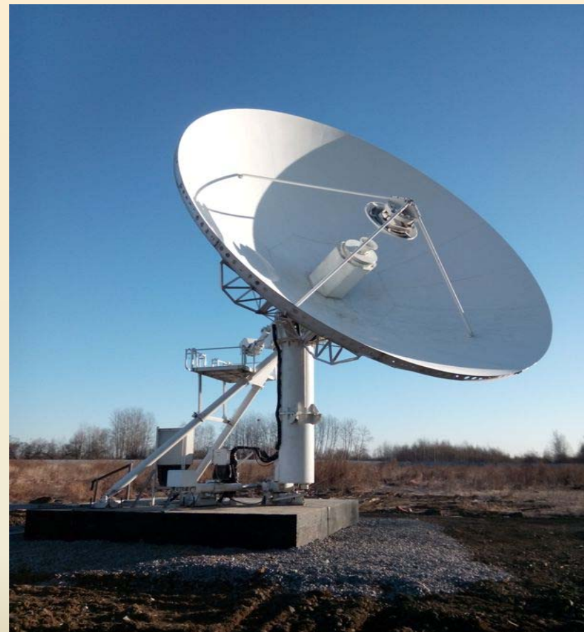
Станция радиоконтроля (г.Хабаровск)
